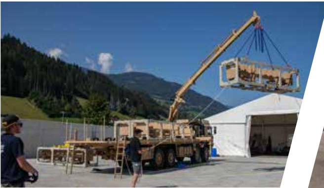
اختبار الونش Crane Test
