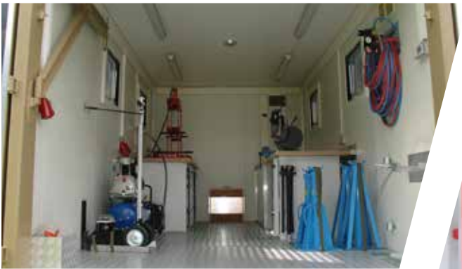
التجهيزات الداخلية لورشة متنقلة Mobile Workshop Interior
