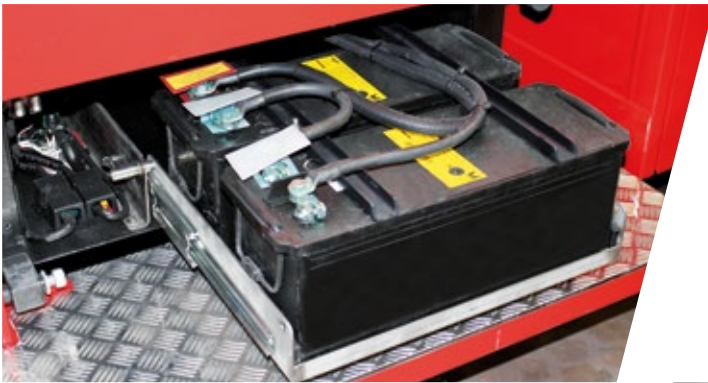
Batterien auf Edelstahlauszug hinter Trittstufen
